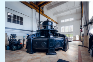
Kraftwerk am Proviantbach 20
